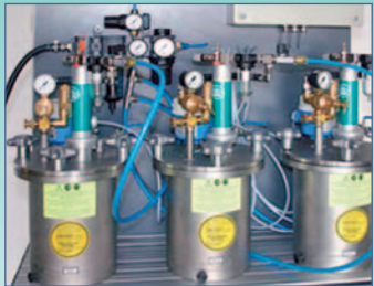
Farbversorgung mit Kleindruckbehältern, ausgerüstet mit Druckluftrührwerken
