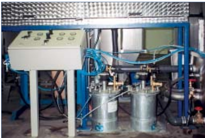
Druckbehälter und Schaltschrank für den automatischen Trennmittel-auftrag bei Profilen
